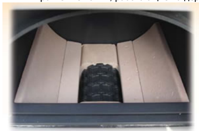
внутренняя часть камеры сгорания
